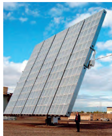
Fot. 25.9. Kolektor fotowoltaiczny z koncentracją o mocy szczytowej 25 kW produkowany przez kalifornijską firmę Amonix. Instalacja o rozmiarze 224 \text{ m}^2 zawiera 5760 soczewek Fresnela z 260-krotną koncentracją optyczną, z których każda oświetla silikonowe ogniwo o sprawności 25%. Jeden taki kolektor, odpowiednio ulokowany na pustyni, generuje 138 kWh dziennie – to wystarczy, by zaspokoić potrzeby energetyczne połowy Amerykanina. Podaję to „ludzkie” porównanie dla lepszego zilustrowania skali potencjału. Fot. David Faiman
