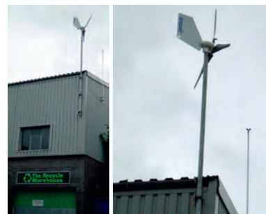
Fot. B.9. Mikroturbina Ampair o mocy zainstalowanej 600 W. Średnia energia generowana przez tą mikroturbinę w Leamington Spa wynosi 0,037 kWh dziennie (co odpowiada mocy 1,5 W).
