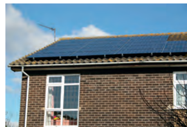
Fot. 6.5. Panele fotowoltaiczne. Dane pochodzą z roku 2006 dla systemu o powierzchni 25 m 2 , znajdującego się w Cambridgeshire. Moc szczytowa dostarczana przez system wynosi około 4 kW. Średnia roczna moc wynosi 12 kWh dziennie, czyli 20 W na metr kwadratowy panelu .
